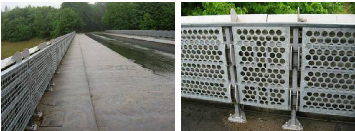
Abbildung 25: Überführung mit nachgerüstetem Sicht- und Blendschutz, Veluwe, Niederlande (Foto: IUS, 05/2008).
